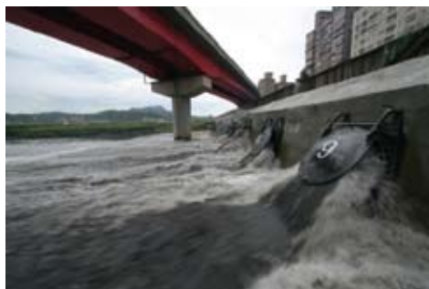
圖 4-3-8 抽水站運作情形
